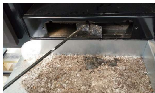
Abbildung Nr.18 - Zugänge zum Reinigen des Rauchabzugs.
