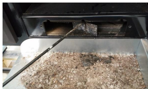
Abbildung Nr.18 - Zugänge zum Reinigen des Rauchabzugs.
