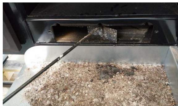
Figura nº18 - Acessos para a limpeza da saída de fumos.
