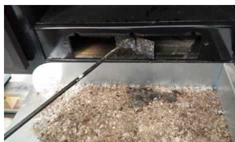
Figura n°22 - Accessi per la pulizia dello scarico fumi.
