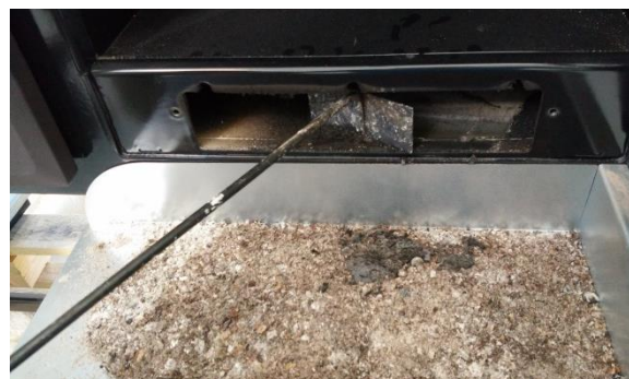
Figure n°17 - Accès pour le nettoyage de la sortie de fumée
